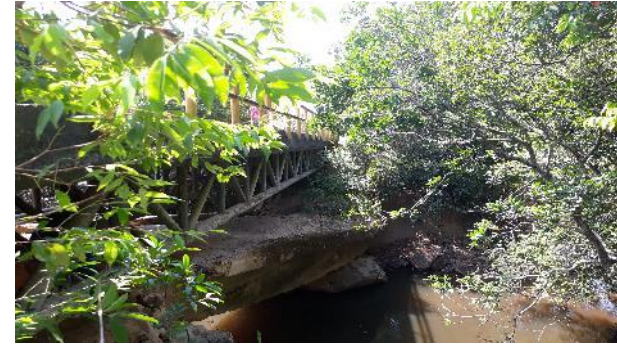
K61+200. EL PILON. ESTRUCTURA ORIGINAL FALLADA POR SOCAVACION DE ESTRIBOS
