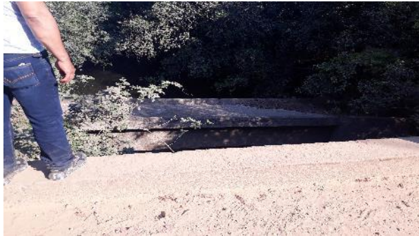
K22+300. PUENTE ORIGINAL CAÑO LA PAYARA COLAPSADO
