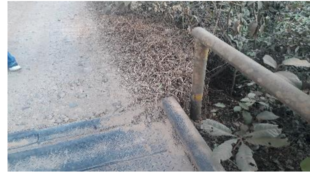
BARANDA EN MAL ESTADO CAÑO LA EMMA
