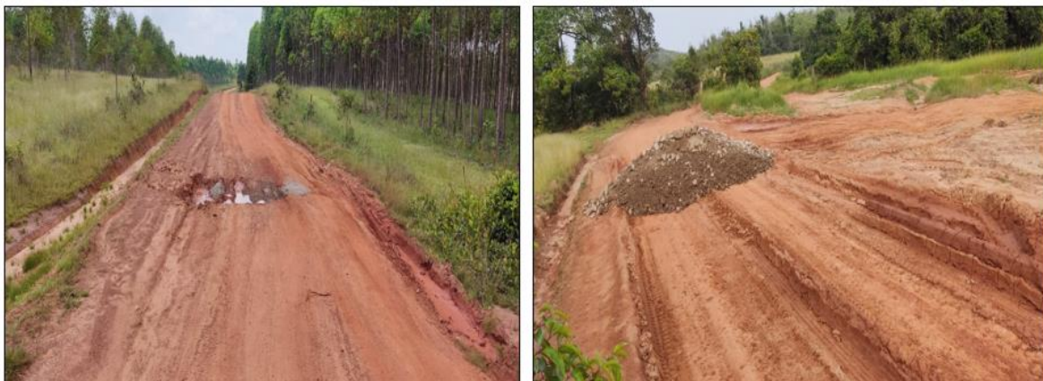
Ilustración 14 Daños existentes en vía de acceso antes del mantenimiento
