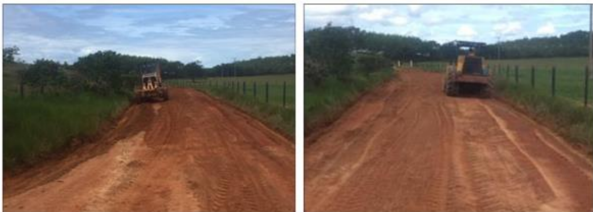
Ilustración 26 Conformación puntos críticos en vía de acceso
