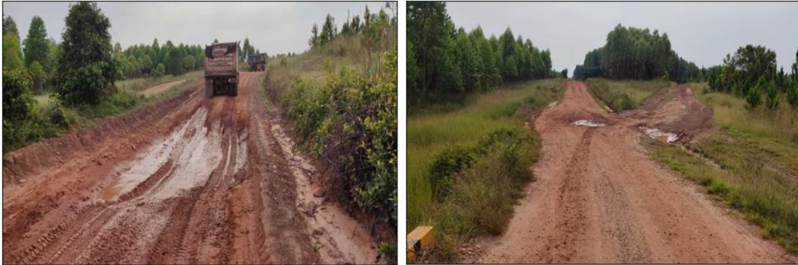
Ilustración 12 Daños existentes en la vía de acceso antes de mantenimiento
