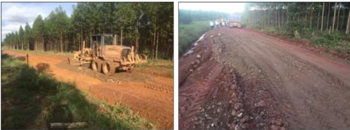
Ilustración 31 Conformación puntos críticos en vía de acceso.
