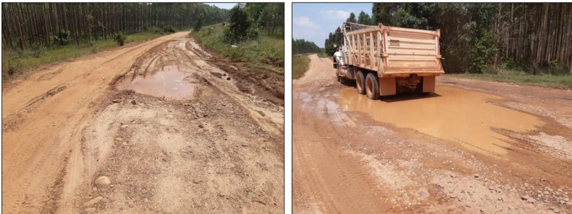
Ilustración 13 Daños existentes en la vía de acceso antes del mantenimiento
