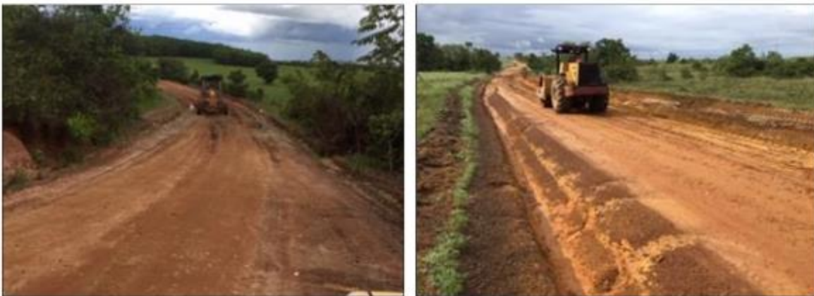
Ilustración 38 Conformación puntos críticos en vía de acceso.
